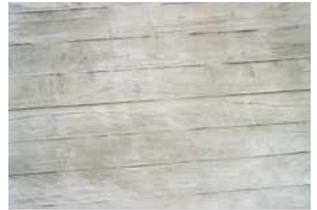
Kaba tahta kalıp dokusu tamir edilen alanlarda yeniden yapılabilir
