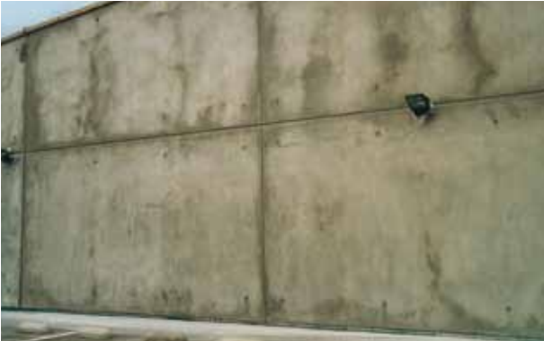
Ağır lekeli yeni beton
