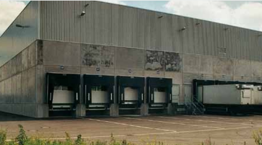
Cephede görülen yoğun lekelenme
