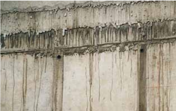
Sıva kusurlarıyla dolgu gerektiren yeni beton
