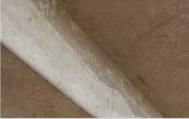
Hafif lekeli yeni beton
